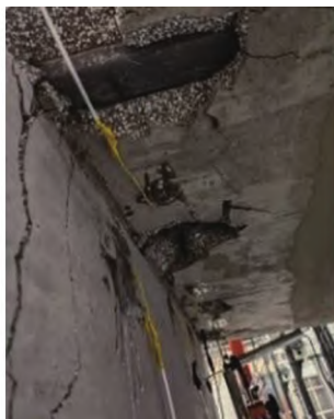
(a) 试件 1 节点区混凝土脱落
